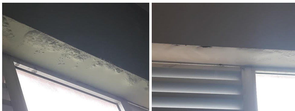
Figuras 16 e 17: Condição das janelas.
