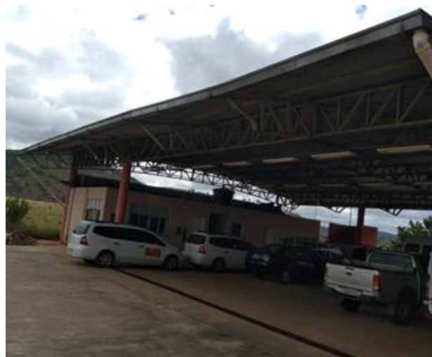
Figura 38: Condição da cobertura do Galpão de Transportes.
