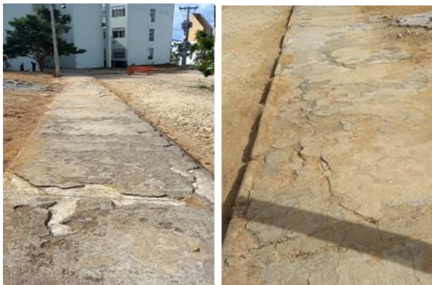
Figuras 45 e 46: Condição das Vias entre o prédio das Salas de aula e prédio FAMUC.
