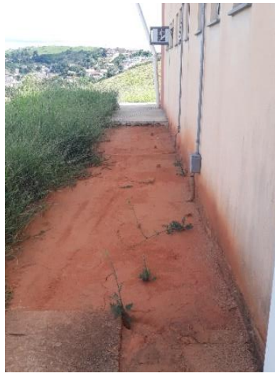
Figura 39: Condição da calçada ao redor do prédio.
