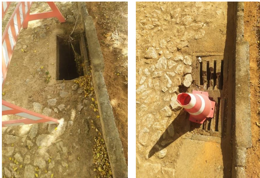
Figuras 49 e 50: Situação das grelhas das vias.
