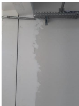
Figuras 09: Condição de fachada interna do prédio.
