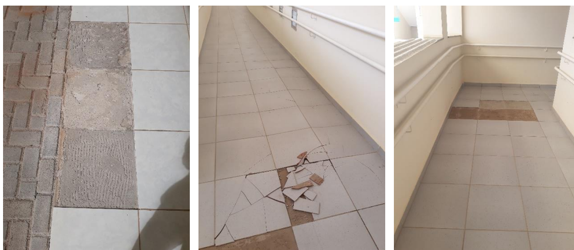
Figuras 29 a 31: Condição Rampa de Acessibilidade do ICET.
