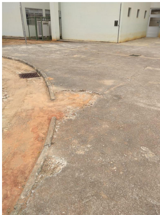
Figuras 48: Situação da calçada situada em frente ao prédio de aulas.
