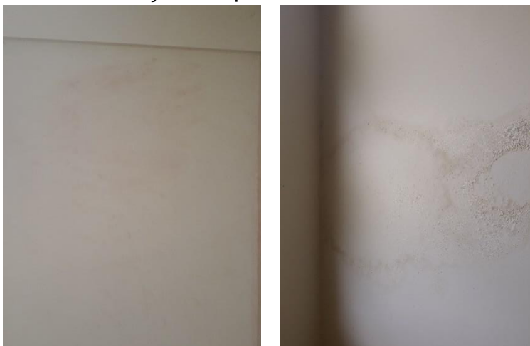
Figuras 24 e 25: Condição das paredes internas do Prédio da FACSAE.
