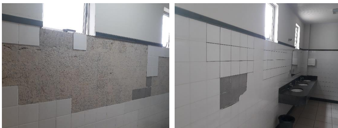
Figuras 21 e 22: Condição dos banheiros do prédio.
