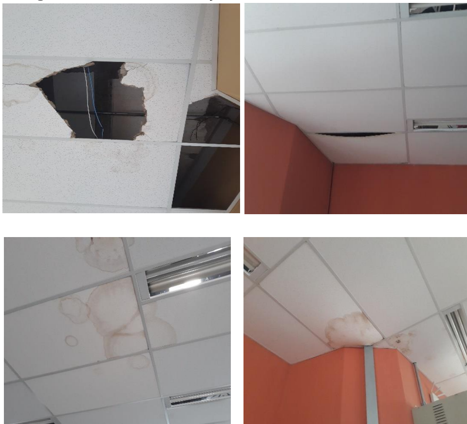
Figuras de 03 a 06: Condições dos Forros dos Miniauditórios.
