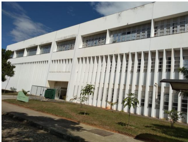
Figura 28: Condição da fachada do ICET.
