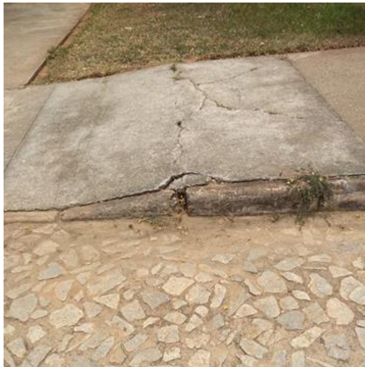
Figuras 47: Condição da calçada próxima ao portal do Campus.
