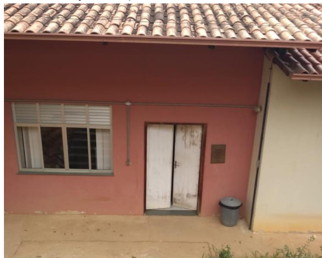
Figura 41: Condição da porta de entrada da Casa de apoio.
