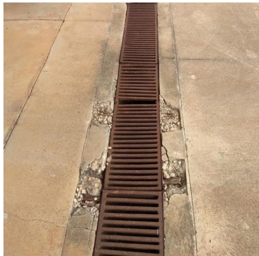
Figura 37: Condição da grelha do Galpão de Transportes.
