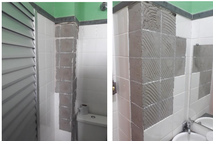
Figuras 14 e 15: Condição dos banheiros do prédio.
