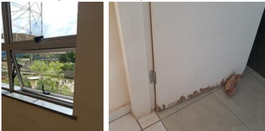
Figura 26 e 27: Condição das esquadrias.
